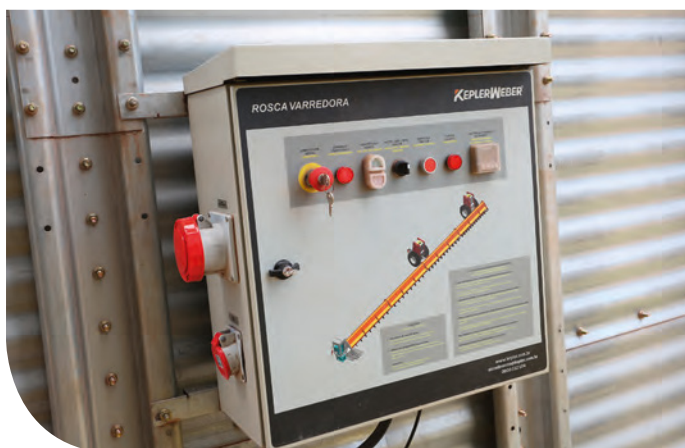
Quadro de Comando
